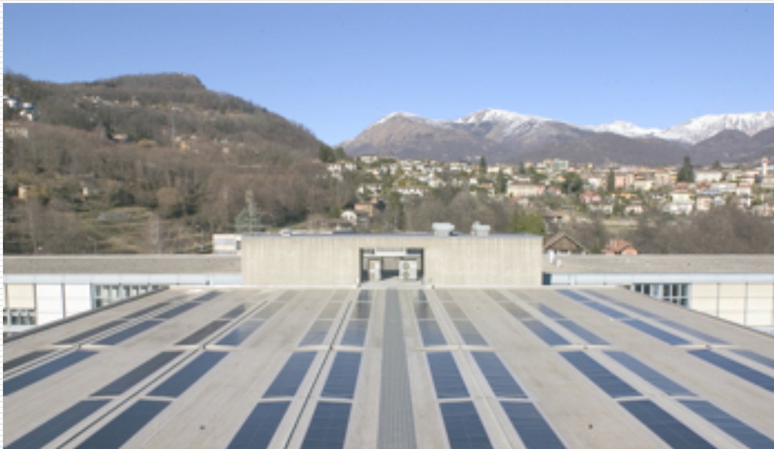
Impianto CPT strato di a-Si laminato nella membrana impermeabilizzante (Sarnafil T)
